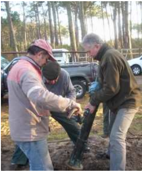
Pour faire comme dans le pignadar, une pompe a été installée.
